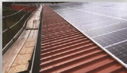
德國215KW分佈式電站
