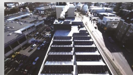
德國165KW分佈式電站
