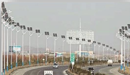
遼寧錦州930KW分佈式電站
