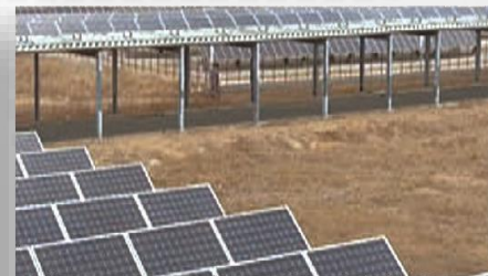
遼寧錦州3MW電站
