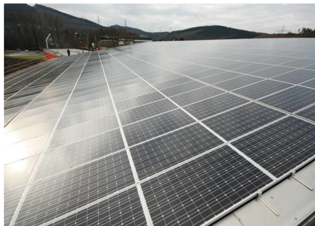
德國Betzdorf 215千瓦屋頂光伏系統
