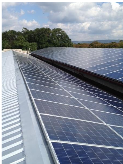
德國Malsch 540千瓦屋頂光伏系統
