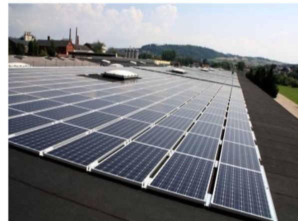
德國Coburg 910千瓦屋頂光伏系統
