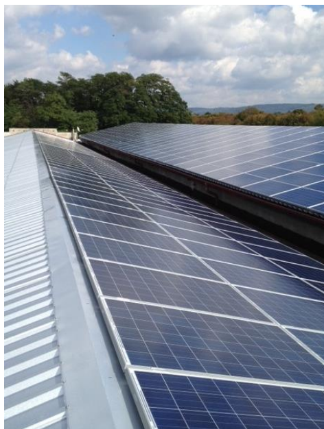
德國Malsch 540千瓦屋頂光伏系統
