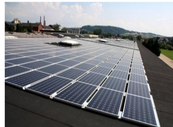
德國Coburg 910千瓦屋頂光伏系統
