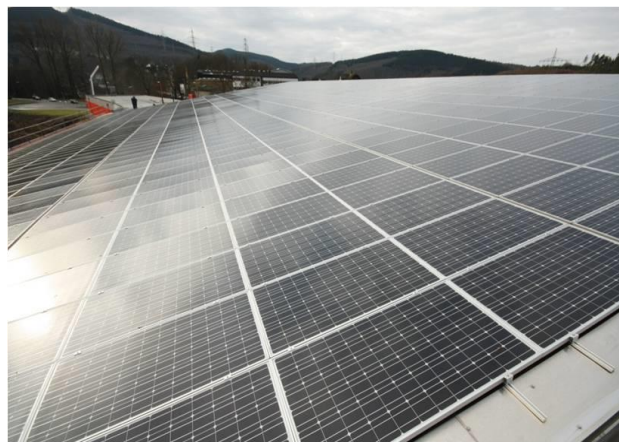
德國Betzdorf 215千瓦屋頂光伏系統
