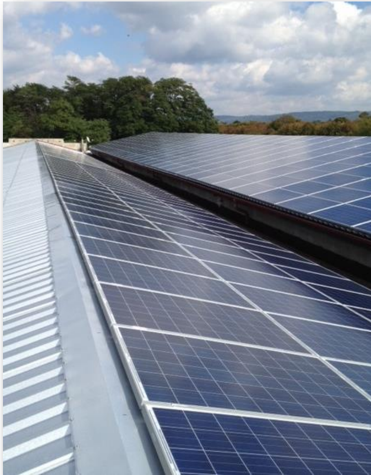
德國Malsch 540千瓦屋頂光伏系統
